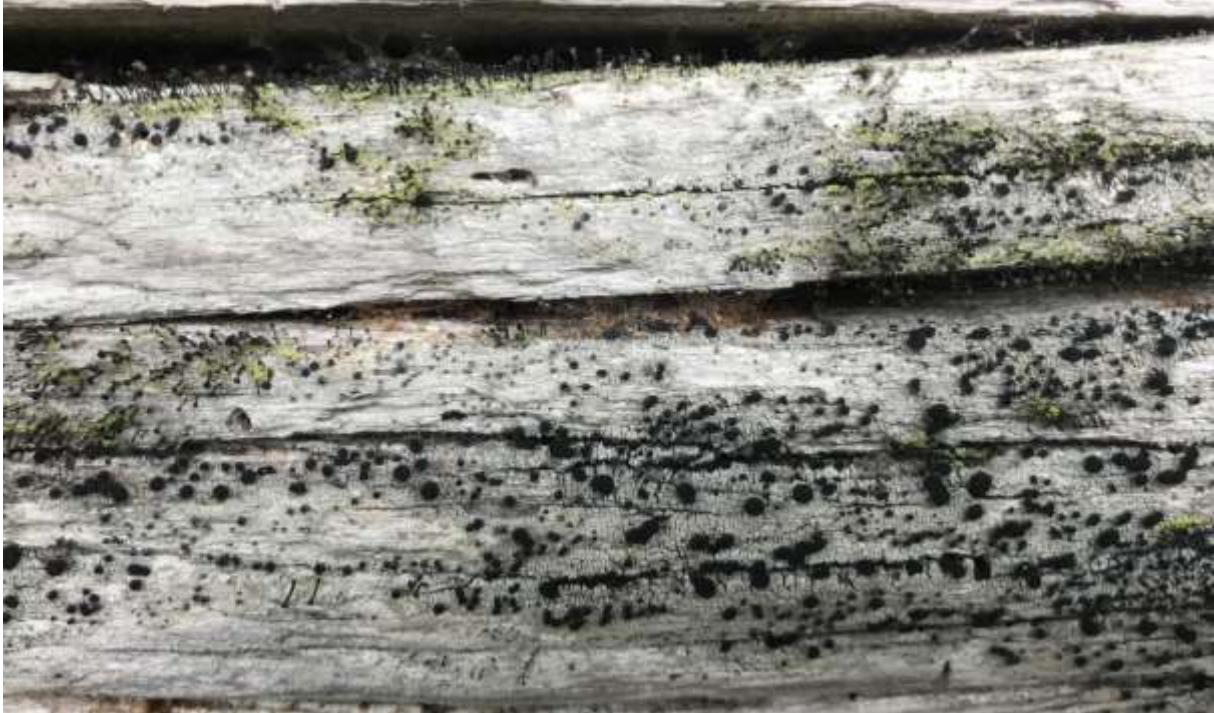
Figur 5: Ein av dei raudlista artene frå kartlegginga er gråsobeger ( Cyphelium inquinans ) (VU), som vart registrert på dei lafta veggane på Litjeslettløa. På biletet ser vi også grønsotnål ( Calicium viride ). Foto: Åshild Hasvik, Bioreg AS © 13.09.2018.
